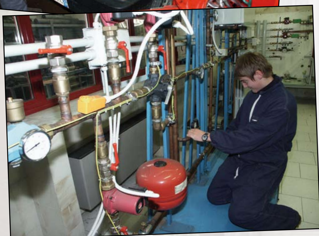
Officina impianti termici
